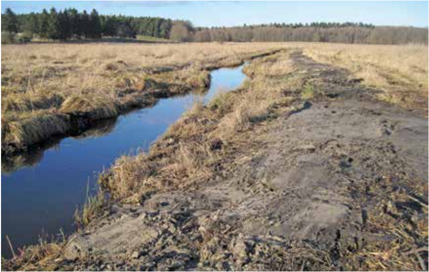
Abbildung 11: Grundräumung in einem bedeutenden und gut bekannten Neunaugenhabitat (Libnower Mühlbach, 2015) Foto: Martin Krappe
