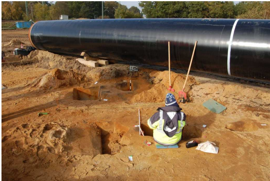
Abb. 5: Die Zeitfenster zwischen Mutterbodenabtrag und Verlegung waren eng, so dass auch für die Ausgrabung häufig nur wenig Zeit blieb.
