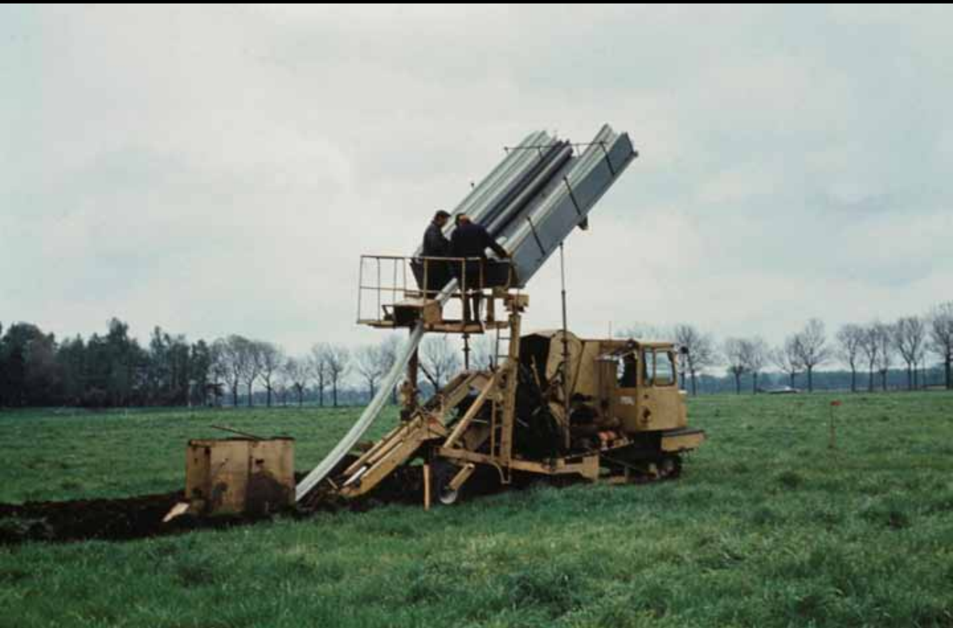
Großdimensionierte Plastrohrdränung mit dem „Meliomat“ zwecks wechselseitiger Wasserregulierung auf degradiertem Moor. Rhinluch bei Linum. (Foto: M. Succow, Mai 1978)
