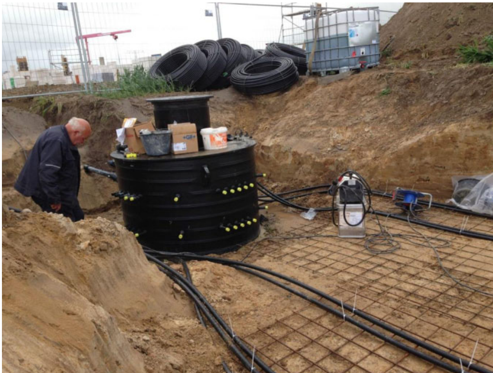
Abb. 18: Verteilerschacht für ein Erdwärmekollektor-System
