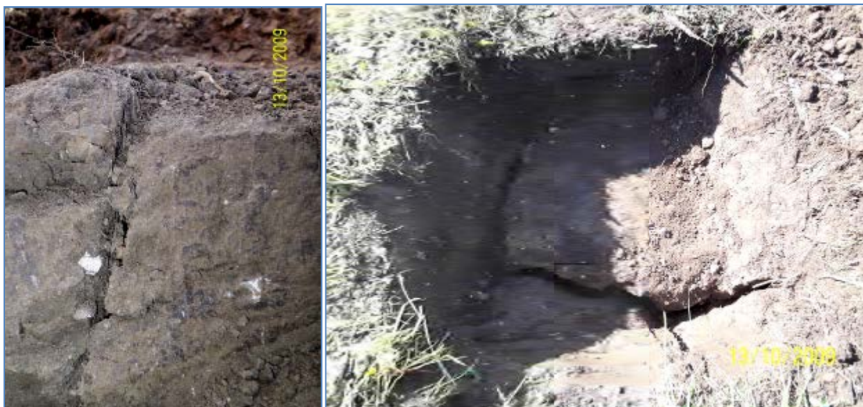
Abb. 12 und 13: Risse im reinen Baggergut ab einer Tiefe von ca. 30 cm
