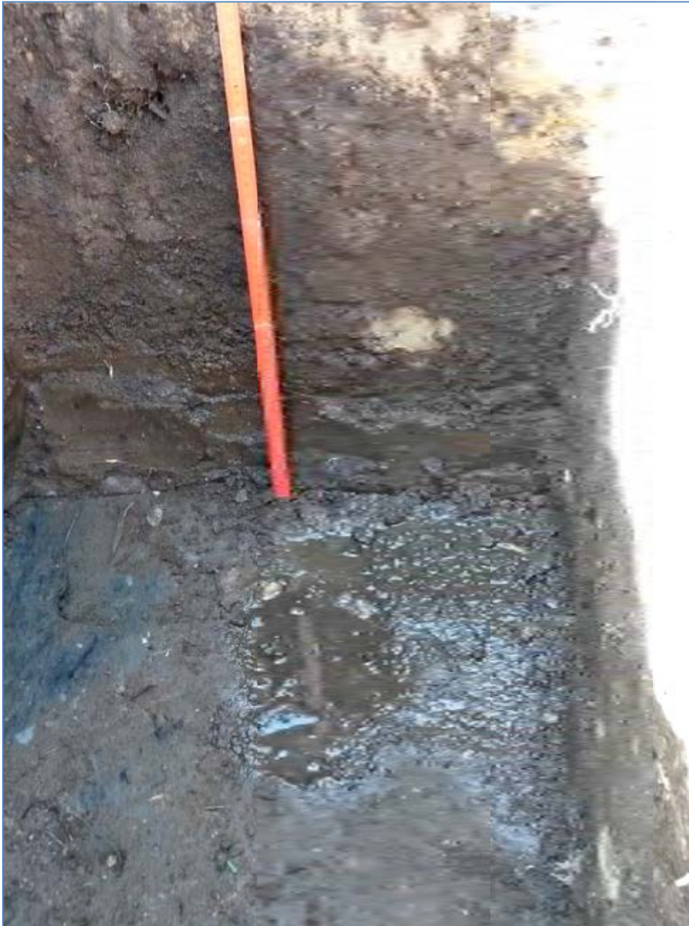
Abb. 18: „Freies“ Wasser am Fuß des Schürfes 1. Risse sind hier nicht mehr erkennbar.
