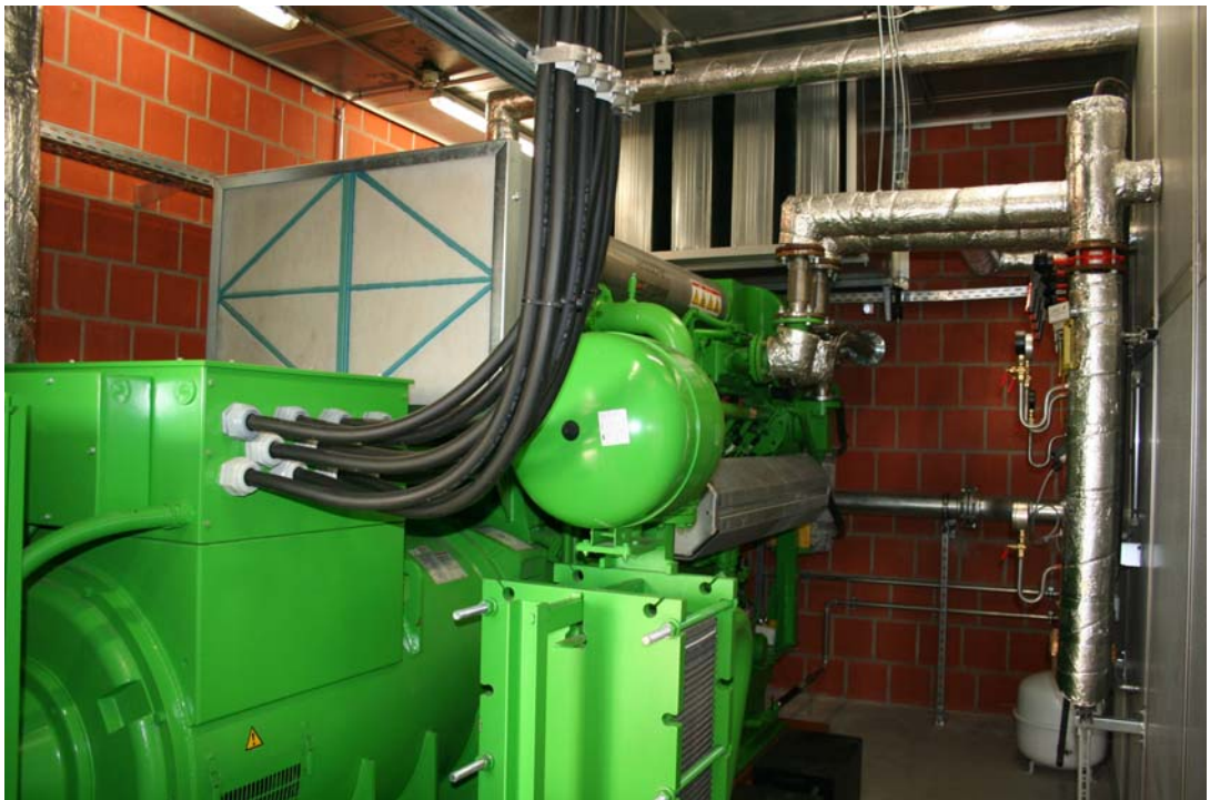
Foto 4: Blick auf einen 12-Zylinder-V-Motor mit einer elektrischen Leistung von 527 kW.
