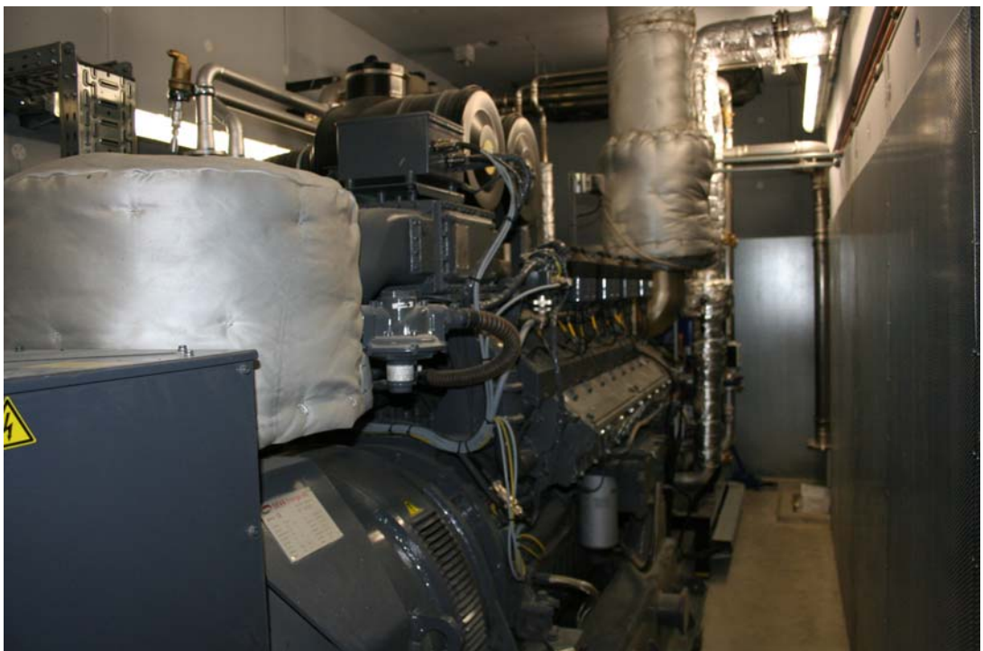
Foto 6: Blick auf einen 16-Zylinder-V-Motor mit einer elektrischen Leistung von 800 kW.
