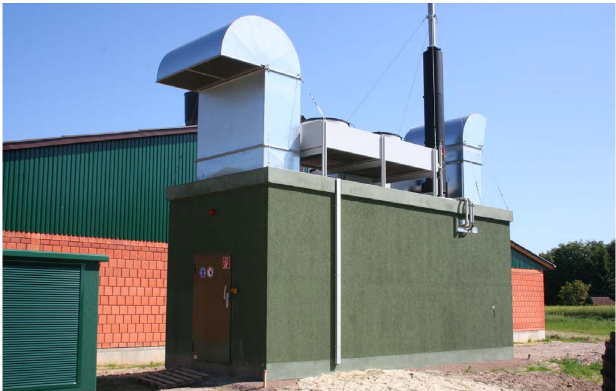
Abbildung 6: BHKW-Anlage in einer Beton-Schallhaube
