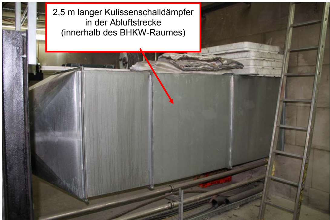
Foto 7: Blick auf einen 2,5 m langen Abluft-Kulissenschalldämpfer, der innerhalb eines BHKW-Raumes in der Abluftstrecke installiert wurde.
