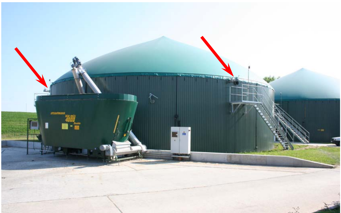
Foto 16: Blick auf einen Behälter, der ausschließlich mit (von außen verstellbaren, siehe Pfeile) Tauchmotorrührwerken ausgestattet ist.
