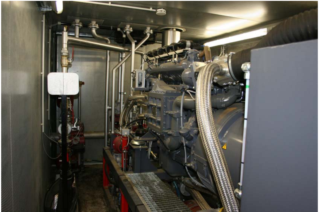
Foto 1: Blick auf einen 6-Zylinder-Reihen-Motor mit einer elektrischen Leistung von 190 kW.
