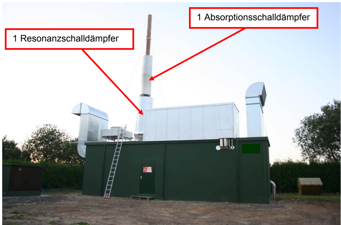
Foto 10: Blick auf ein wirksames Schalldämpfersystem über das gesamte Frequenzband, bestehend aus insgesamt 2 Schalldämpfern.
