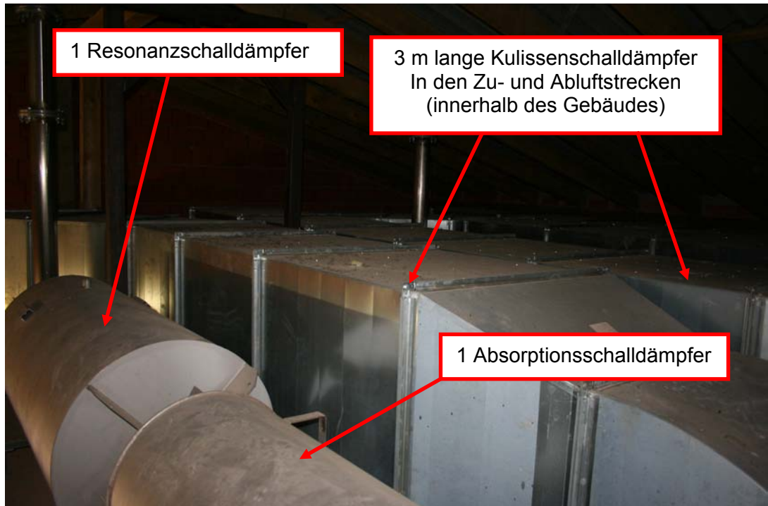
Foto 8: Blick auf die Decke eines BHKW-Raumes. Auf dieser sind die verbauten Schalldämpfersysteme zu erkennen, die somit noch innerhalb des Gebäudes angeordnet sind.
