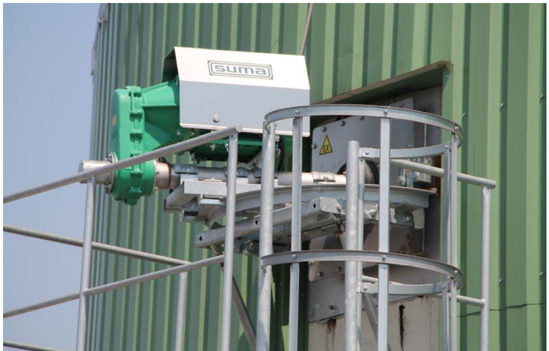
Foto 18: Blick auf ein Stabmixrührwerk mit außen anliegendem Antriebsmotor.
