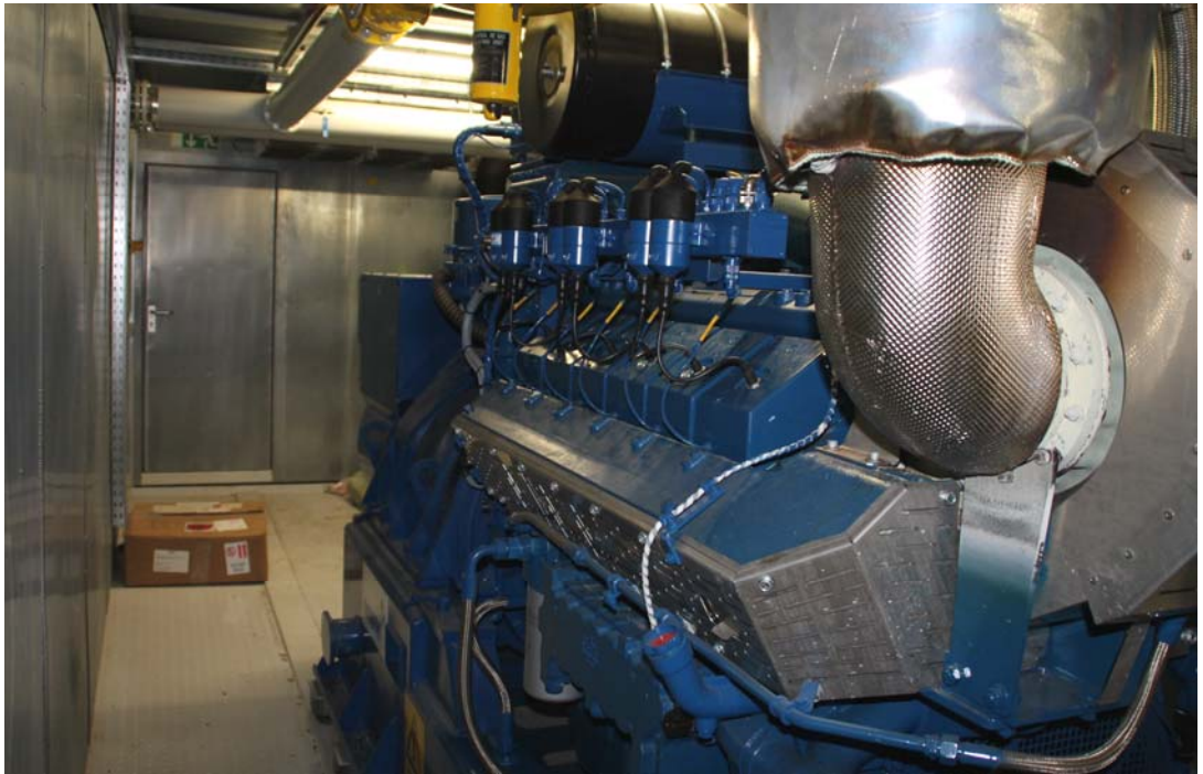
Foto 5: Blick auf einen 12-Zylinder-V-Motor mit einer elektrischen Leistung von 600 kW.
