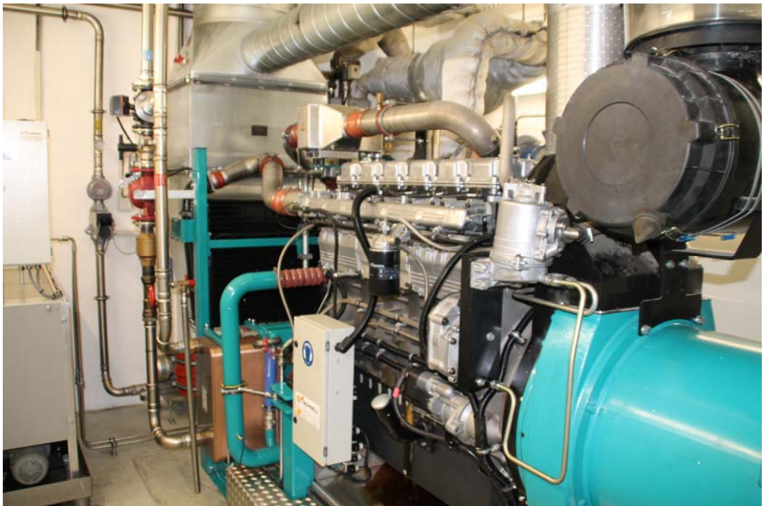
Foto 2: Blick auf einen 6-Zylinder-Reihen-Motor mit einer elektrischen Leistung von 265 kW.
