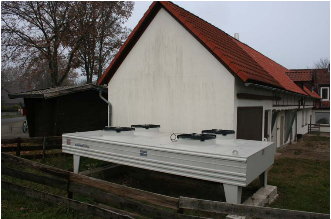
Foto 11: Blick auf eine sehr leise Ausführung eines Notkühlers für einen BHKW-Motor mit einer elektrischen Leistung von 195 kW.
