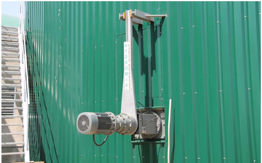
Foto 17: Blick auf ein Paddelrührwerk mit außen anliegendem Antriebsmotor.
