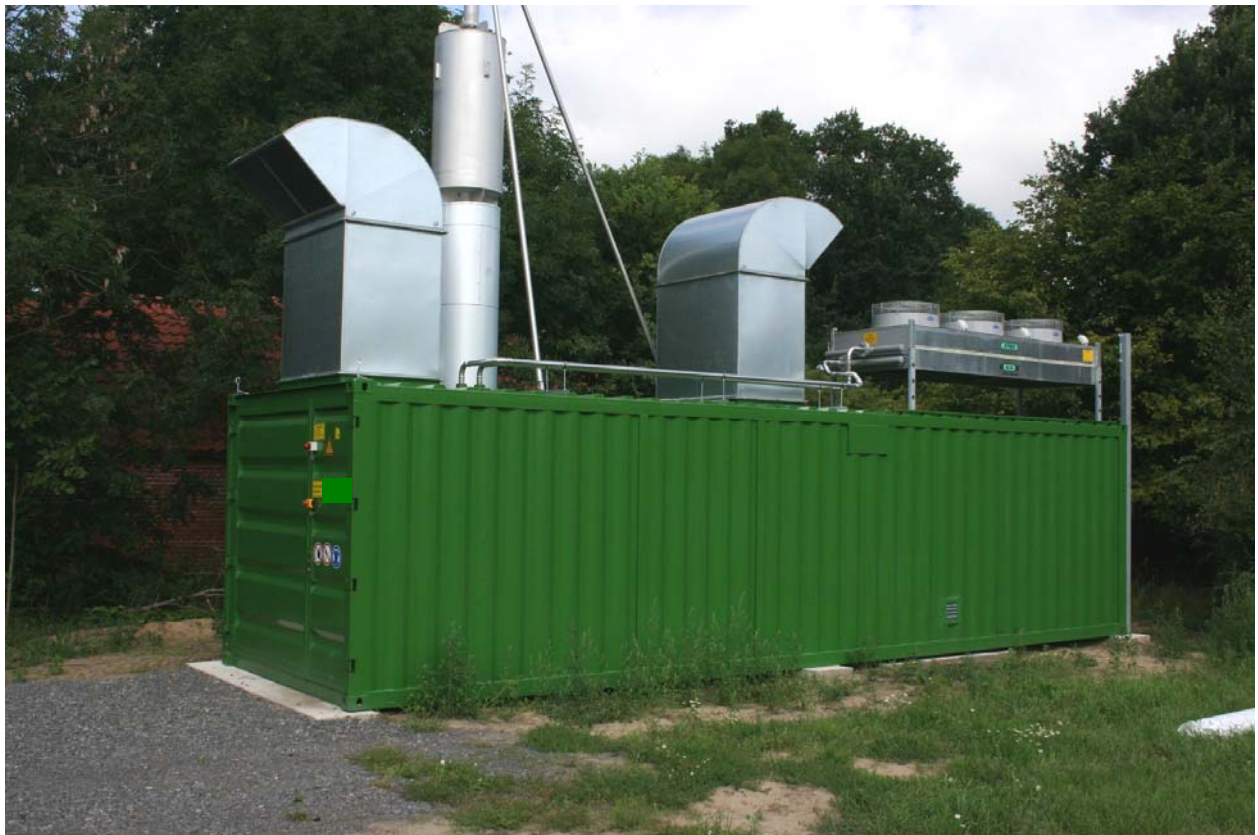
Abbildung 5: BHKW-Stahlblech-Container in Super-Silent-Ausführung
