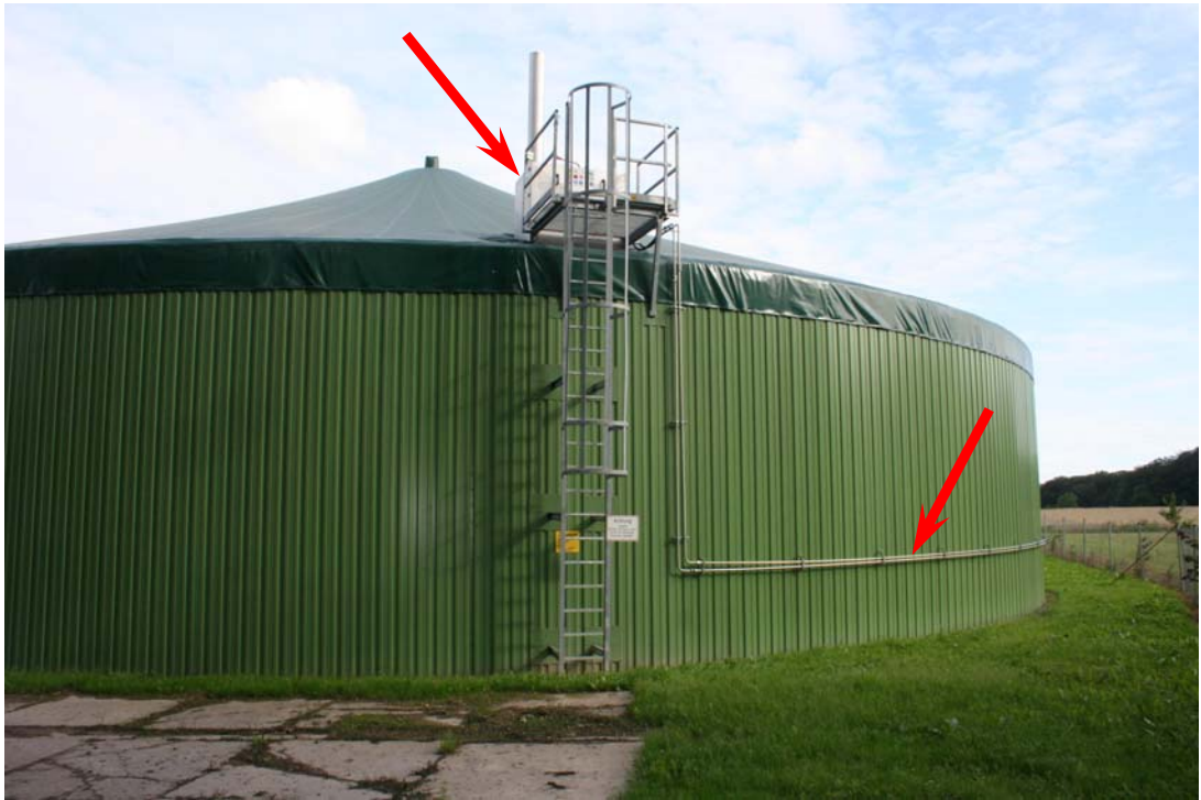
Foto 19: Blick auf einen Behälter, der mit hydraulischen Rührwerken ausgestattet ist. An der Behälter-Außenwand verlaufen die Druckleitungen bis zu den etwa 50 m entfernt in einer leichten Einhausung befindlichen Hydraulik-Aggregaten. Von diesen Druckleitungen (rechter Pfeil) erfolgt ein Körperschalleintrag in die Blechverkleidung, die Luftschall abstrahlen. Ebenfalls erfolgt eine Luftabstrahlung von den Service-Schächten (linker Pfeil) der Rührwerke.
