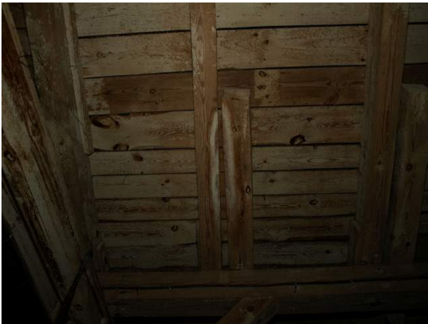
Abb. 42: Doppelbalken mit typischen Verfärbungen
