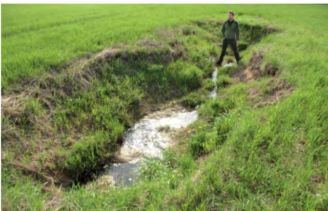
Abbildung 4-18: Durch Druckabfluss zerstörte Rohrleitung in einem Graben bei Elmenhorst (nahe Rostock), Foto: Institut biota GmbH
