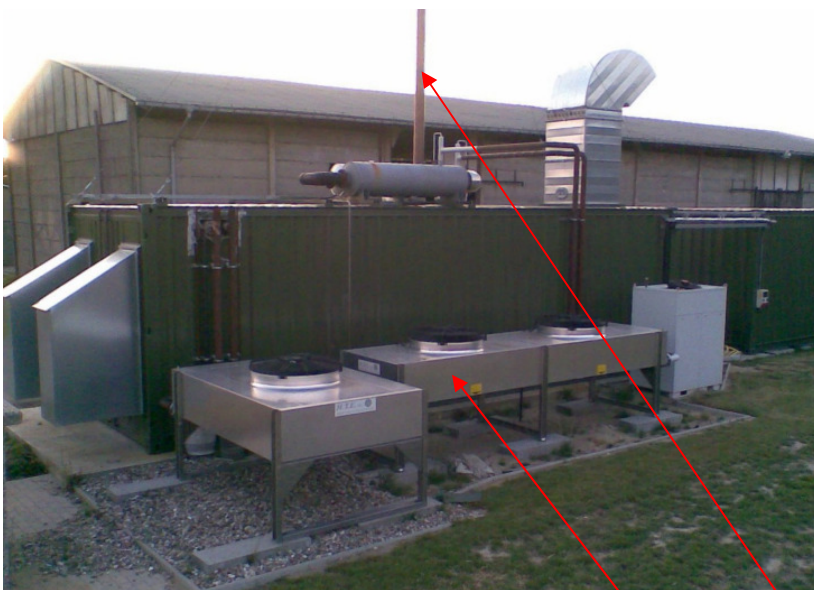
Bild 3: Blick aus östlicher Richtung auf die Anlage (Rückkühler – Kamin)
