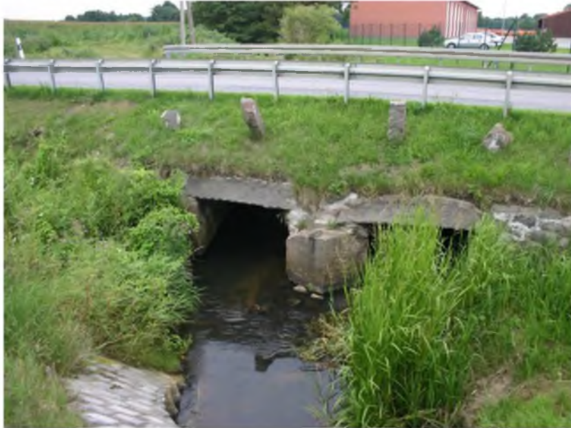
Vorhandene Durchlässe im Zuge der L 11: aktueller Zerschneidungsgrad: Sehr hoch
