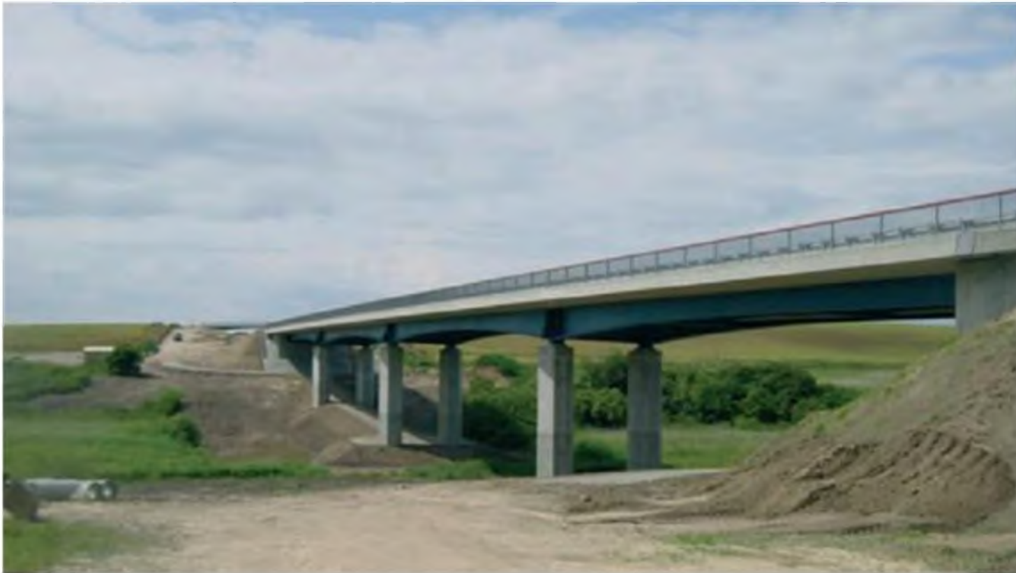
BW 03 – Brücke im Zuge der B 105n über den Klosterbach bei Ribnitz-Damgarten, Foto: Straßenbauverwaltung Mecklenburg-Vorpommern
